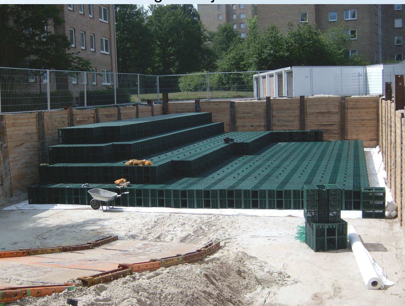
Foto: Kombiniertes Sicker- und Rückhaltebecken
