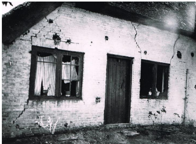
Die Bombenschäden am Wohnhaus Scharenberg
